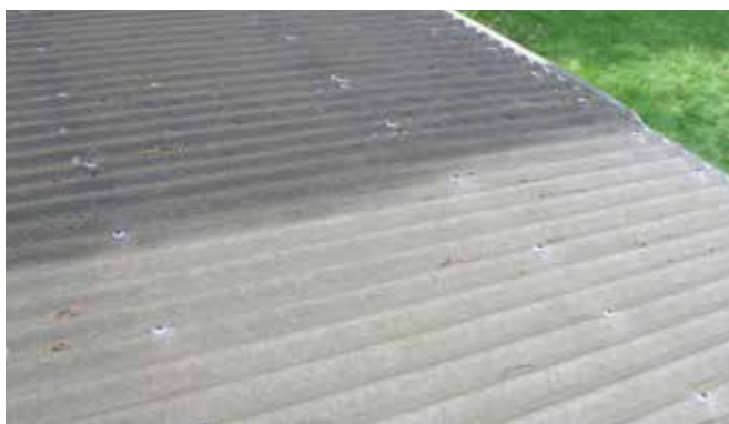
Tak av glasfiber med angrepp av alger. Två år efter behandling med Grön-Fri.
