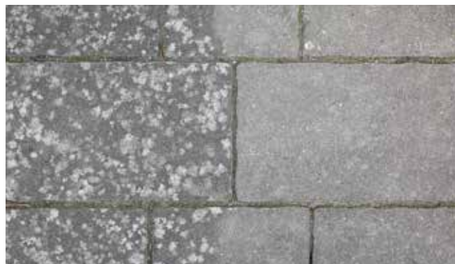
Gångplattor av betong med påväxt av alger och lav. Två år efter behandling med Grön-Fri.
