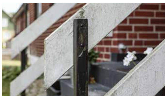
Täckmålat trappräcke med påväxt av mögel och alger.
