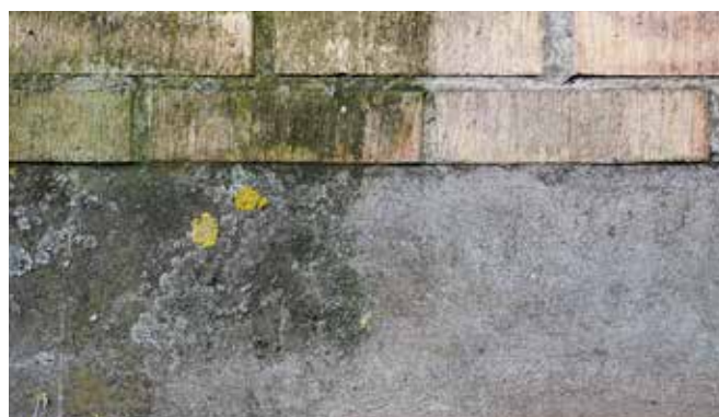
Tegelvägg och putsad grund med alger och lav. Två år efter behandling med Grön-Fri.
