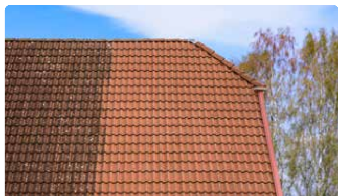
Tak av tegelpannor med alger och lav. 18 månader efter behandling med Grön-Fri.
