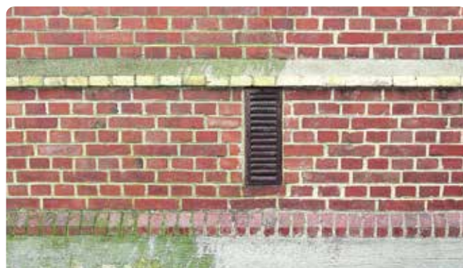
Tegelvägg med angrepp av gröna alger. Ett år efter behandling med Grön-Fri.
