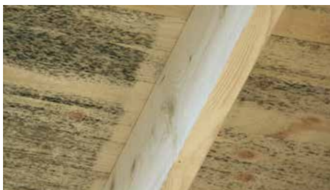
Mögel på råspont i takkonstruktion.
