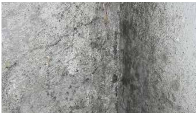
Putsad vägg i källare, svart av påväxt.
