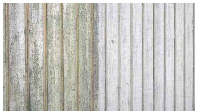
Täckmålad fasad med angrepp av mögel och alger. Behandlad med Prick-Fri.
